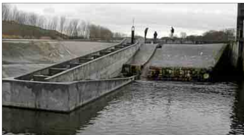
Escala de arquetas situada en La Flecha, Salamanca.
